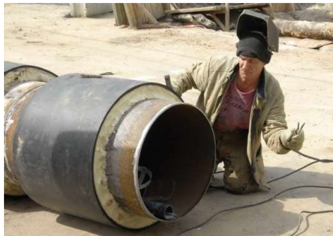
Тепло- и водоснабжение
